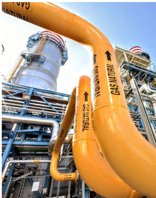
Central de cogeneración. Salamanca, Guanajuato.
